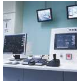
中央監視操作盤
