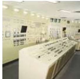
高炉 中央監視盤
